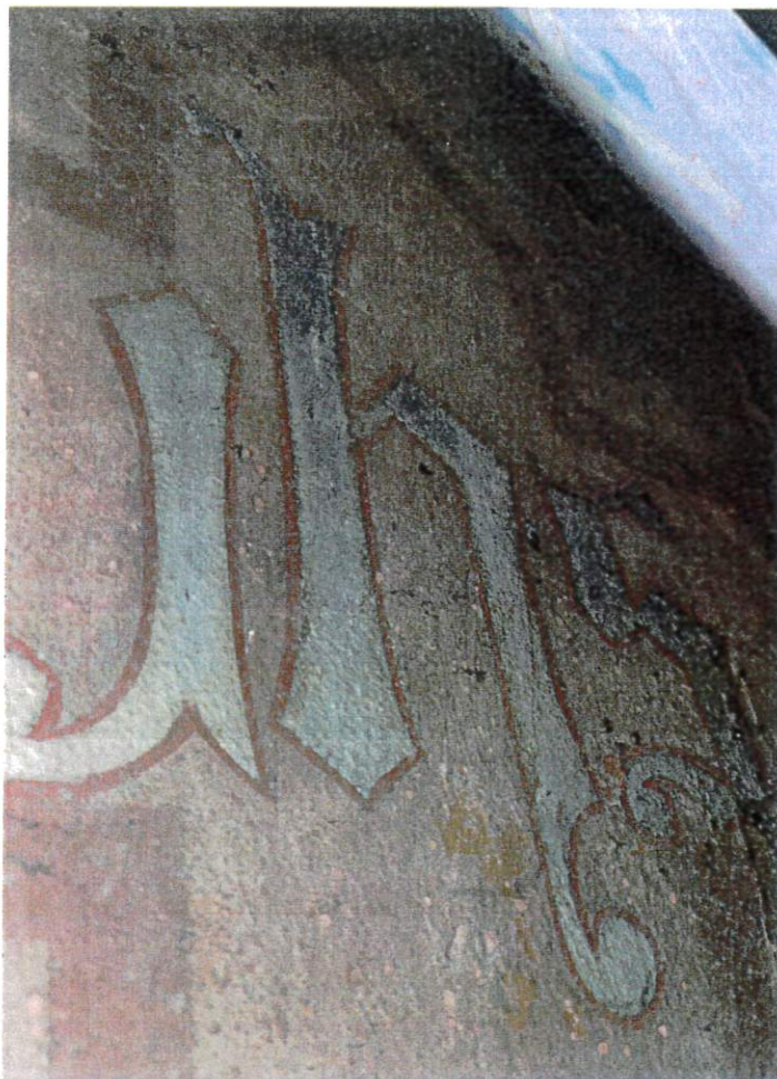
Pawłowice, kościół pw. św. Jana Chrzciciela, ślady zachowanej i niezamalowanej polichromii z pocz. XX w. (ściana prezbiterium)
